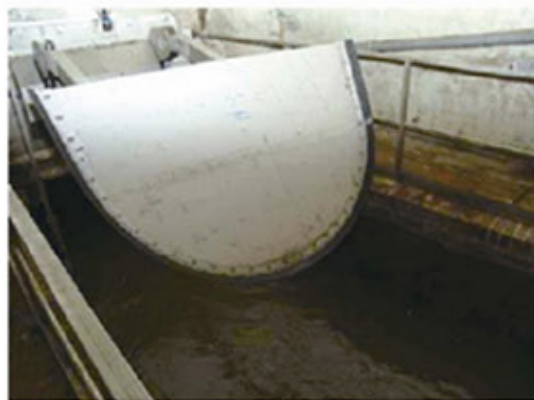
大型拦蓄冲门（大管径排水管道）
